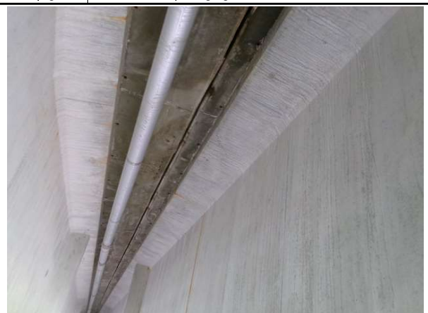
손상현황 • S5 박락(0.3m×35.0m) 원 인 • 다짐미흡, 열화 등 조치방안 • 단면보수
